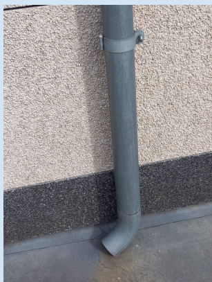
Nedløbsrør trykker på tagdugen
