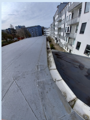
Vandet fra taget ledes ned af facadepladerne
