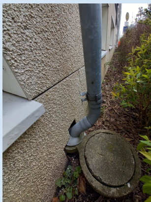
Hængselstift til nedløbsrør er gået løs
