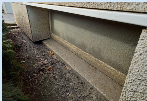
Kældervinduer er udsat for meget opsprøjt fra terrænet
