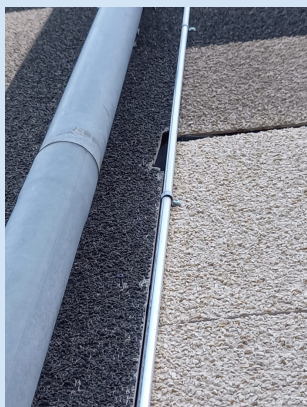
Skruerne har sluppet underlaget og mindre revne i pladen
