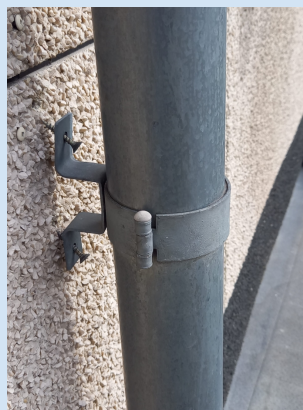
Hængselstift til nedløbsrør er gået løs
