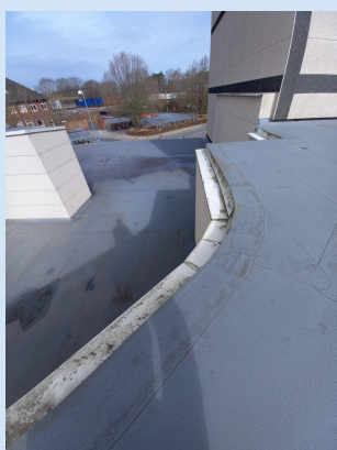
Vandet fra taget ledes ned af facadepladerne
