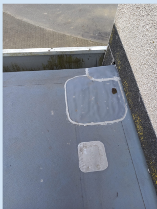
Utæthed, som fornylig er forsøgt lappet
