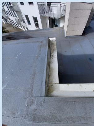
Vandet fra taget ledes ned af facadepladerne
