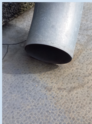
Nedløbsrør trykker på tagdugen
