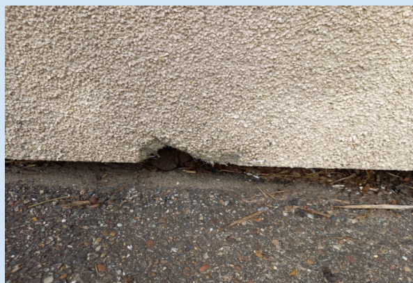
Mindre skade på facadepladen
