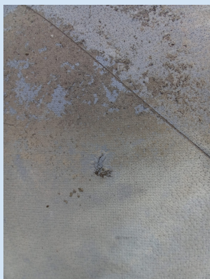
Hul i overfladen af tagdugen
